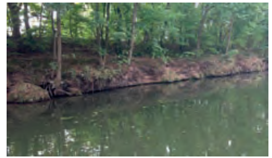
Noch nicht stabilisierte Ufer des Niegripper Altkanals Foto: Ehle-Ihle Verband
