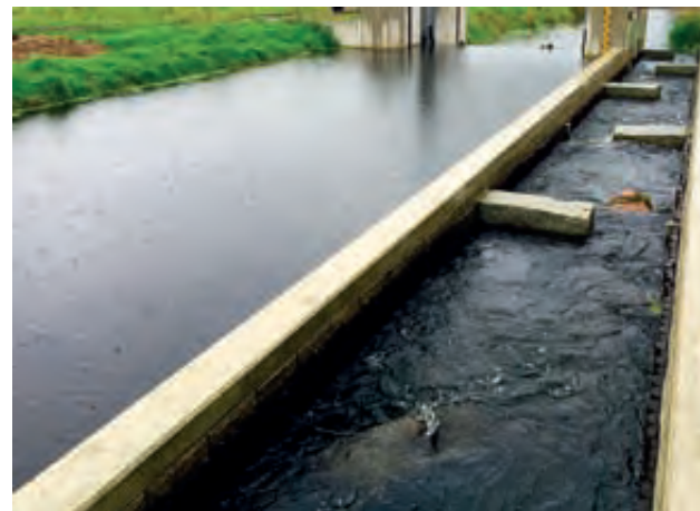
Der neue Fischpass verläuft direkt neben der Untermilde, Fische können durch die Aufstiegsanlage den Stau Butterhorst ohne Probleme passieren.
