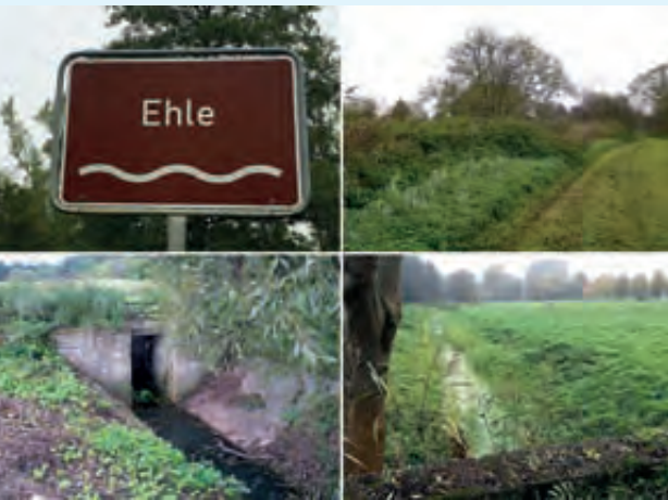
Hinweisschild in Möckern (oben links), Foto: M. Kühnast Der fast zugewachsene, begradigte Lauf der Ehle bei Loburg (oben rechts); Der alte, begradigte Lauf der Ehle und der marode Durchlass unter einem Wirtschaftsweg (unten links); Fotos: Ehle-Ihle Verband; Der alte, begradigte Lauf im Herbst 2015 (unten rechts), Foto: M. Kühnast
