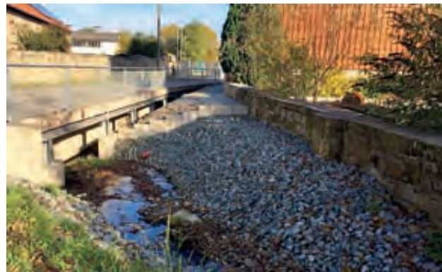
Ein echter Hingucker: Der offene Grabenlauf unter dem Fußweg in Morsleben
