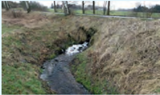
Der alte, ökologisch nicht durchgängige Straßendurchlass bei Diesdorf, Foto: UHV Jeetze
