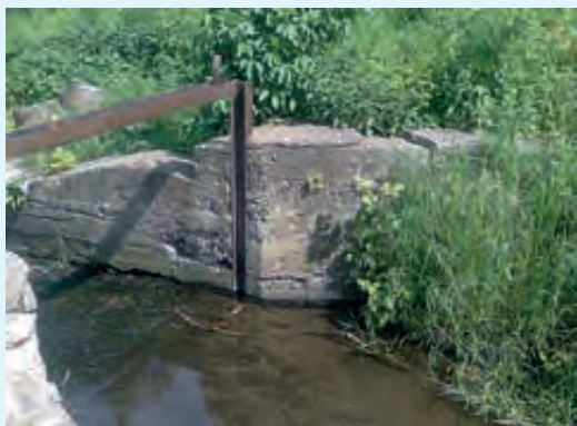
Verrotteter Beton, verrosteter Stahl: Der alte Stau an der Pfeffermühle war unschön und eine ökologische Problemzone, Foto: UHV Ilse Holtemme
