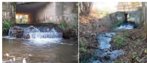
Der alte Durchlass für den Steinbach bei Bad Bibra mit dem Absturz, der ein ökologisches Hindernis war vor der Realisierung; Fotos: UHV Untere Unstrut
