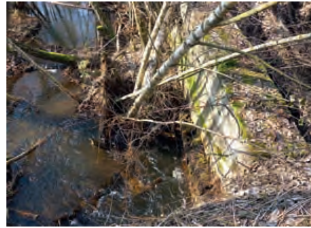
Die marode Stauanlage an der ehemaligen Papierfabrik: ein unüberwindliches Hindernis für Wasserlebewesen Foto: UHV Stremme/Fiener Bruch
