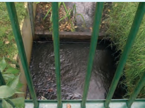
Die Zuflussregelung für die Sohlgleite, mit der die durchfließende Wassermenge gesteuert wird Foto: M. Kühnast
